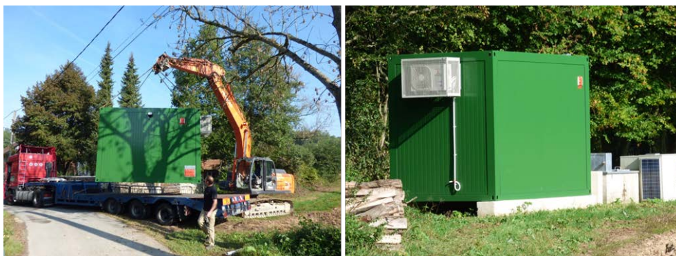
• Figure 1: Mise en place de la station Haute-Fréquence sur le sous-bassin versant des Avenelles (Observatoire ORACLE/BVRE Orgeval), financée par l'ANR CRITEX
