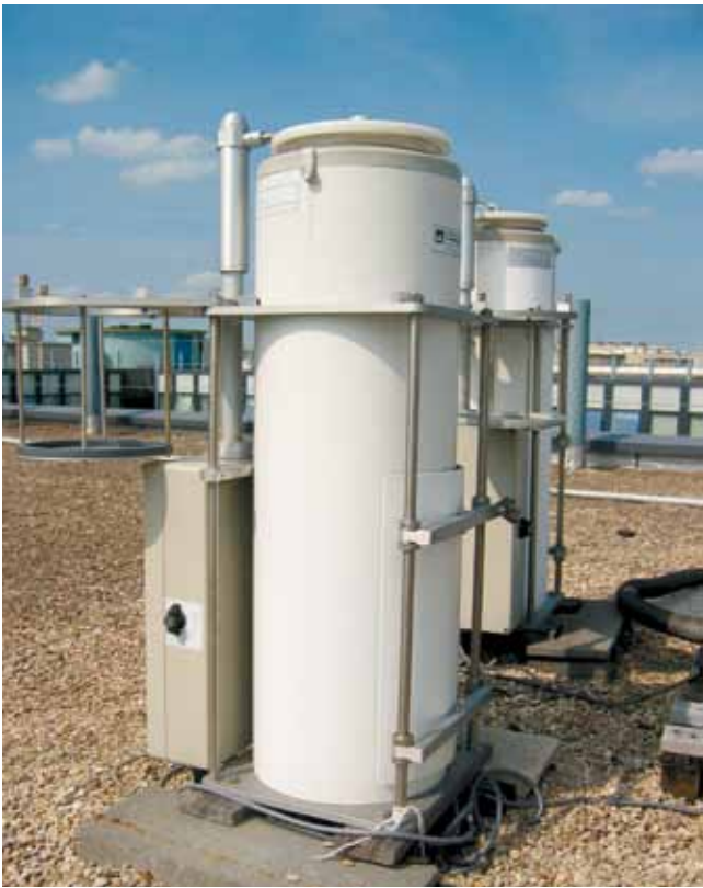
Figure 32 : Préleveur séparatif de dépôt atmosphérique de temps sec et de temps de pluie. Le couvercle mobile, déclenché par un détecteur de pluie, permet de prélever séparément les dépôts particuliers de temps sec et les apports liés à la pluie.
